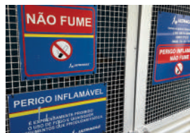
CENTRAL DE GÁS
