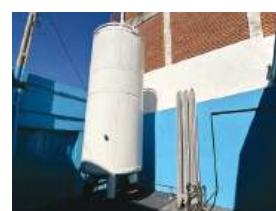
TANQUE DE OXIGÊNIO
