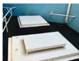
TRATAMENTO DE ÁGUA (ASTRAL)
