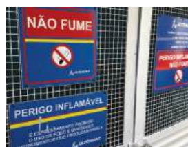
CENTRAL DE GÁS
