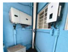
ENERGIA FOTOVOLTAÍCA (USINA)
