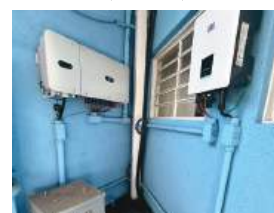
ENERGIA FOTOVOLTAÍCA (USINA)
